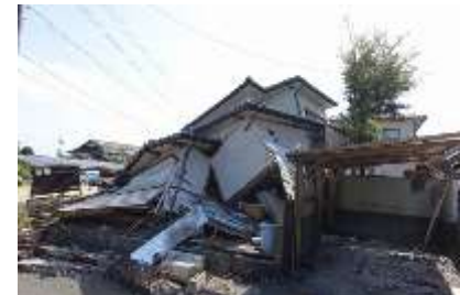
熊本地震で倒壊した新耐震基準の木造住宅
