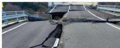
道路の被災状況
