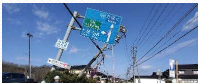
電柱・電線の被災状況
