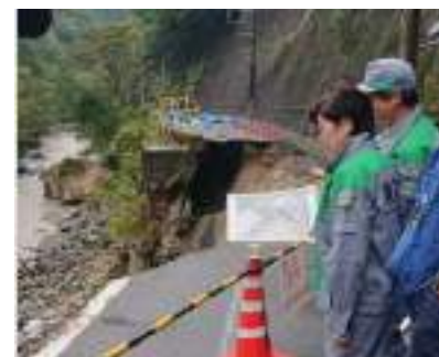
台風により被害を受けた都道204号線(2019年10月15日)
