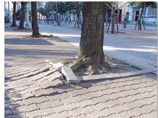
根上がりによる歩道不陸
