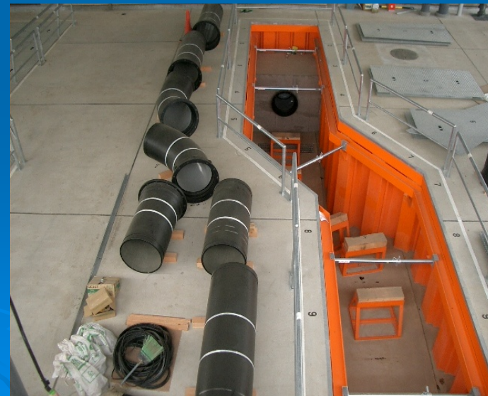
【実技フィールド(大口径配管実技場)】
