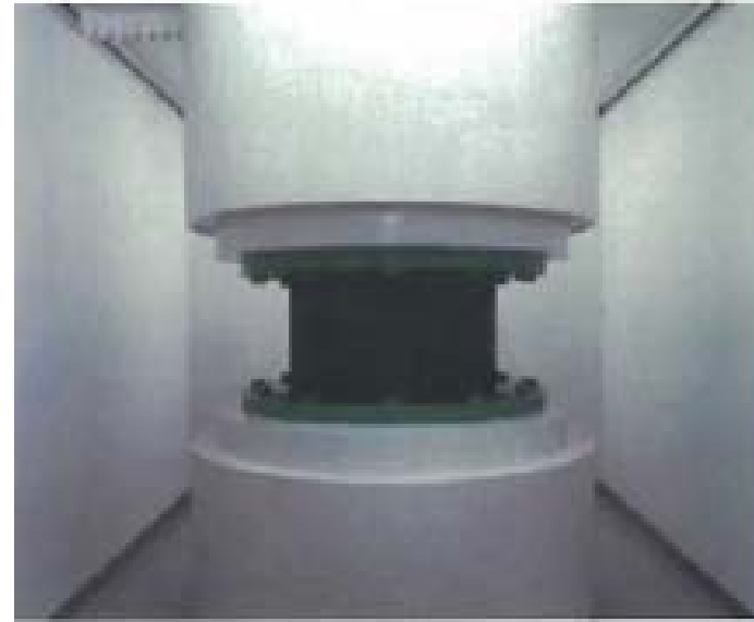
免震装置設置状況
