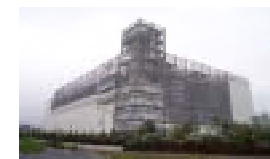
廃棄物発電施設
