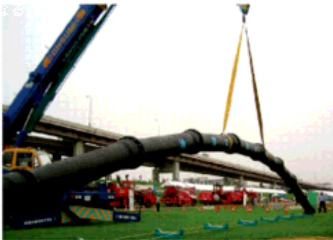
▲ 抜け出し防止継手の水道管
