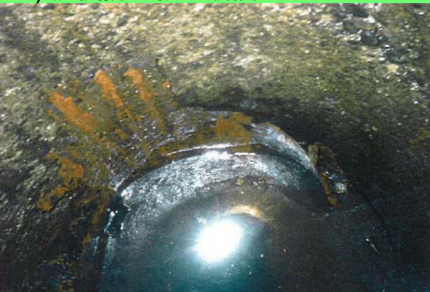
15) 洗掘防止板の破損
