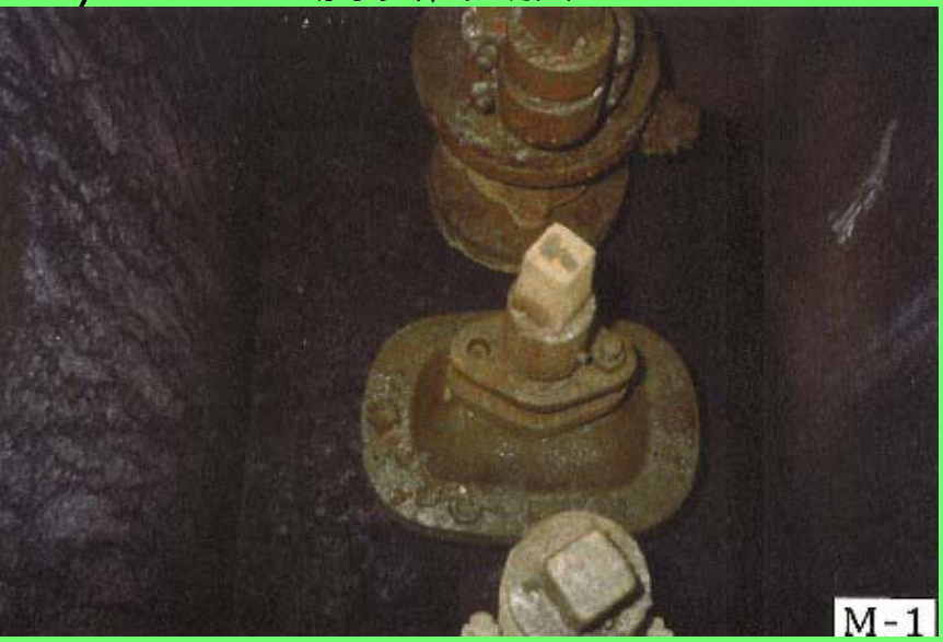
11) ボルトの腐食、欠損
