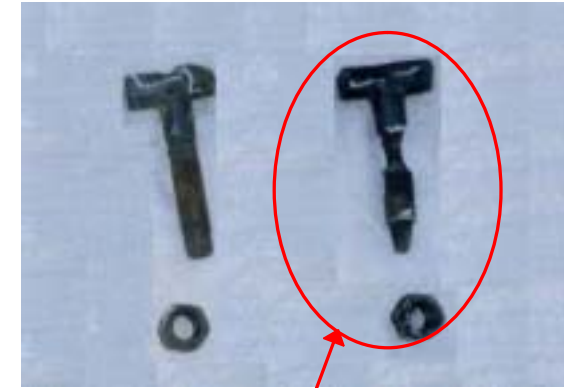
ボルト腐食大
