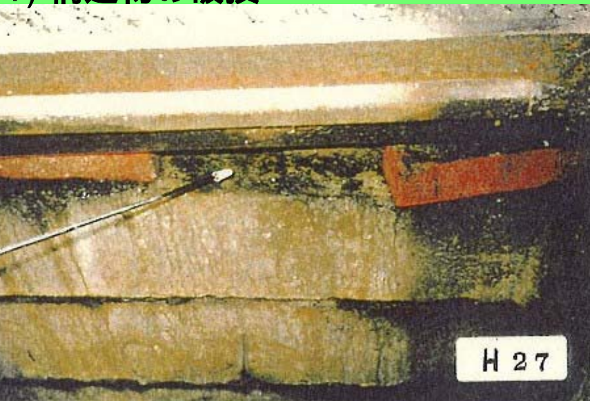
7) 構造物の破損
