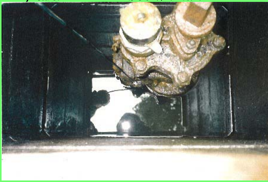
12) 補修レバーの腐食、欠損
