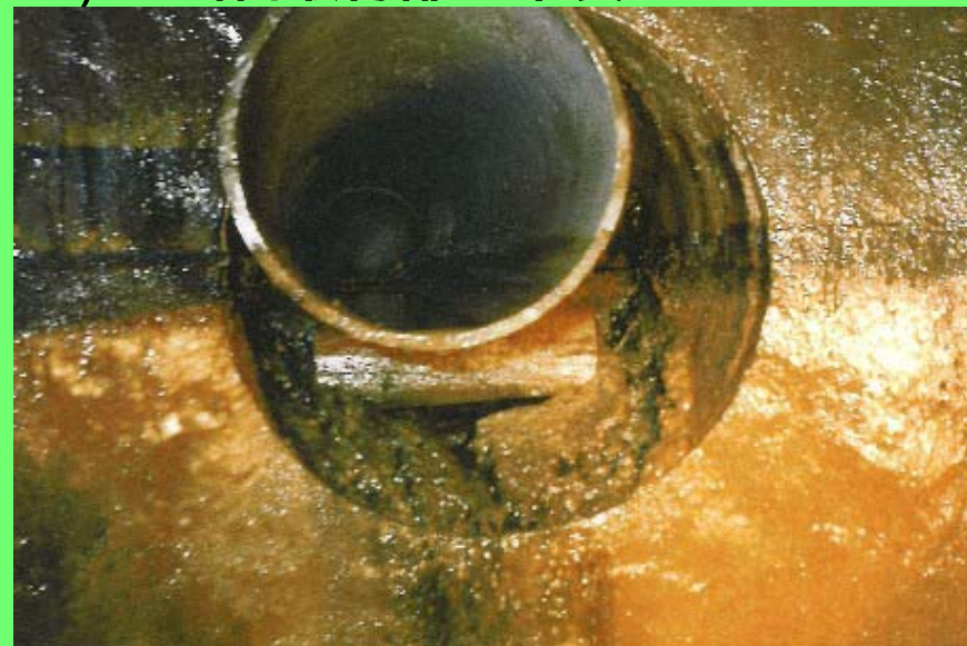
16) 吐出管取付部の不良
