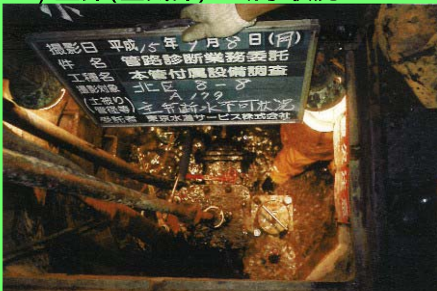
14) 主弁(空気弁)の断水状況
